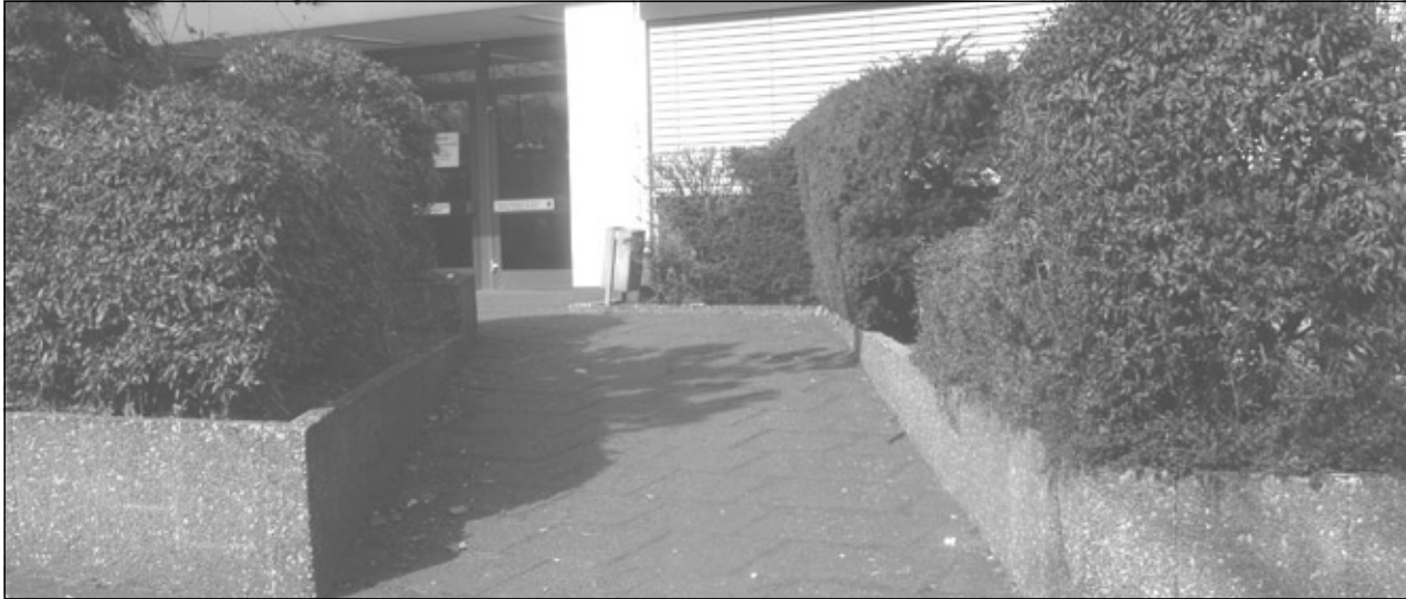
Fehlende Handläufe an den Steigungen
